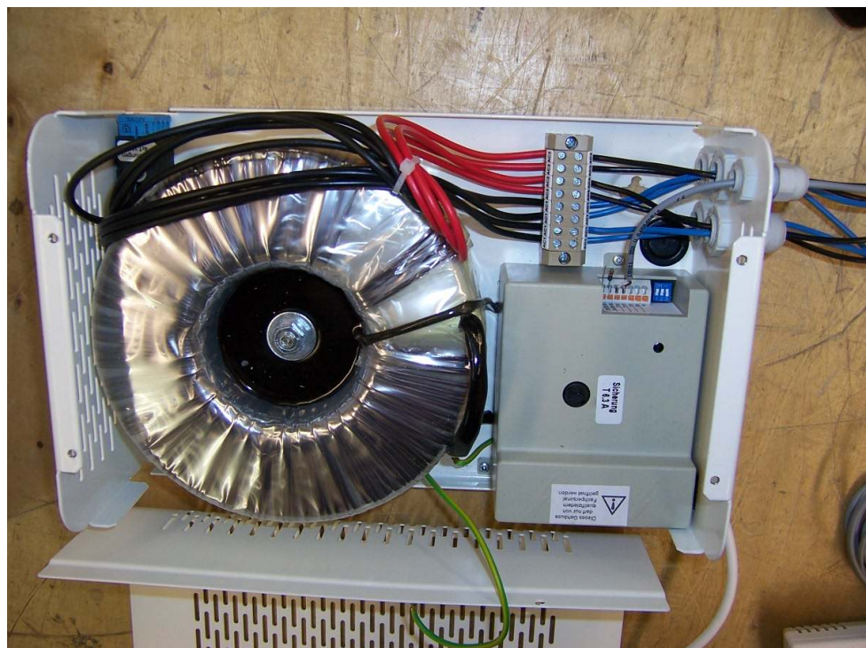
Bild 18. Heizungssteuerung HS12.2 Innenansicht
